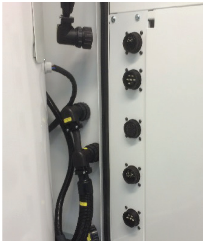
Bildet viser avmonterte bajonettkoblinger
