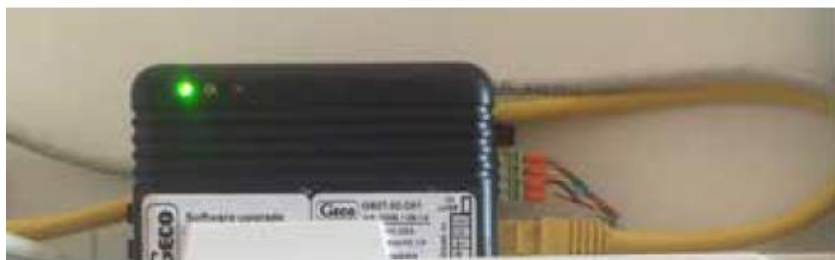
Bild 5.3. Modem i "Solar compartment boksen":
