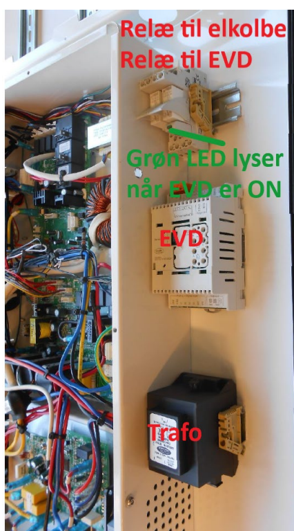
Ved 1 fase sidder der kun 1 relæ til elkolben og 1 relæ til EVD
