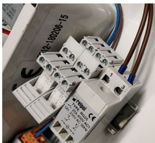
Ved 3 faser er der monteret yderligere et kraftrelæ med 2 udgange til 2 styk max. 3 kW elkolber
